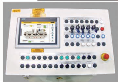
Operators console with Touchpanel. Bedienerkonsole mit Touchpanel.
